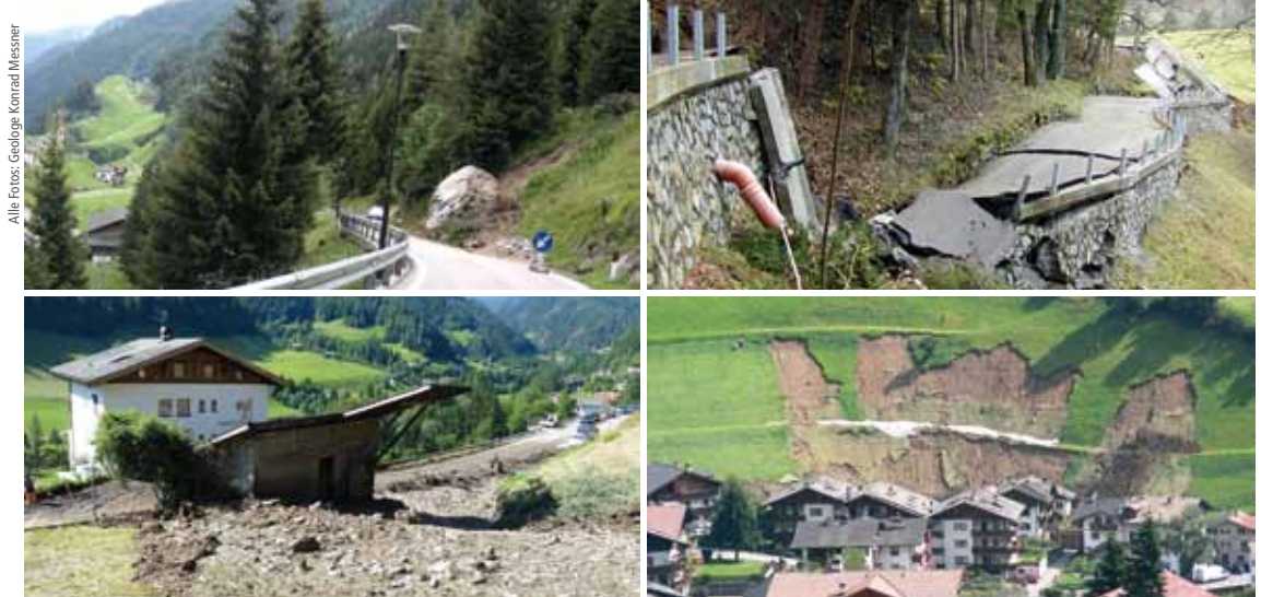
Von links oben (im Uhrzeigersinn): Steinschlag in Rabenstein (Moos in Passeier), Rutschung in Mörré (St. Martin in Passeier), Vermurung in St. Pankraz (Ulten), Rutschung in St. Leonhard in Passeier.
